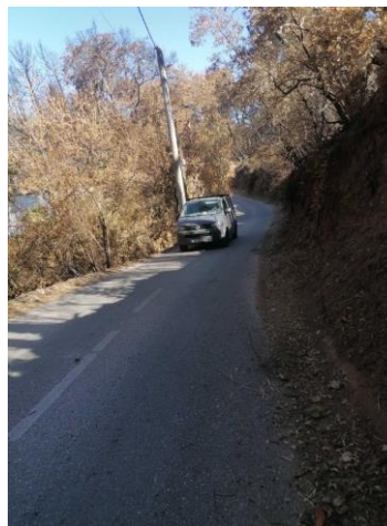
Στένωση οδοστρώματος μετά τη πυρκαγιά
