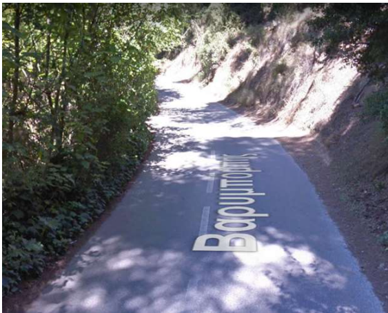
Στένωση οδοστρώματος προ πυρκαγιάς μετά τη πυρκαγιά
